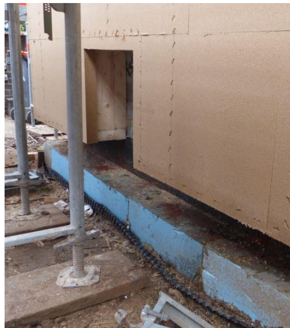
Die Kellerwände im Sockel zum Erdreich sind von außen mit XPS-Platten gedämmt. Für die Außenwand wählte der Architekt hier eine Holzträger-Konstruktion mit Decksicht aus Holzfaserplatten. In die Zwischenräume wird Zellulose eingeblassen. © Passivhaus Institut
