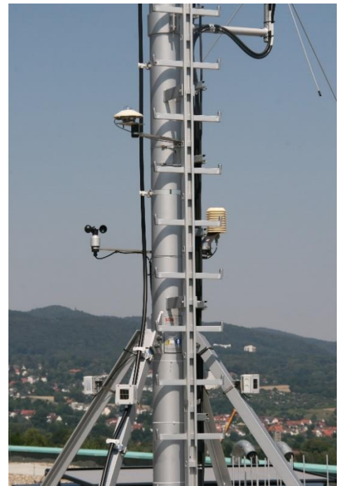
Der Antennenmast auf dem Dach des Verwaltungsgebäudes in Nordhessen. Das Passivhaus Institut installierte daran seine Geräte für die Wettermessung. © PHI
